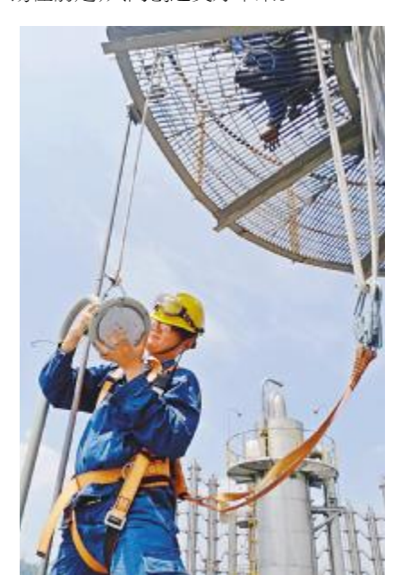
严格安全管理,随时关注设备运行情况
