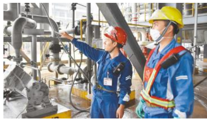
国庆期间,永祥多晶硅全员放弃休息,加班加点推进复工复产工作。图为永祥多晶硅工段长同属地人员一起确认设备管线置换情况,为复产做好准备
