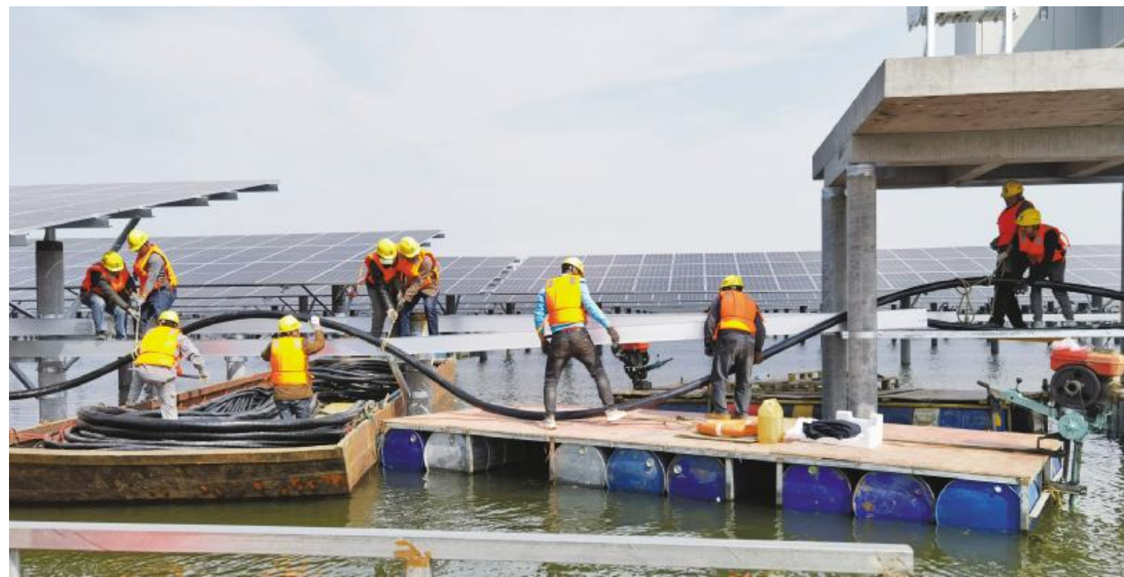
《众人划桨开大船》 陈巍 齐心协力,敷设好电站的每一根电缆
