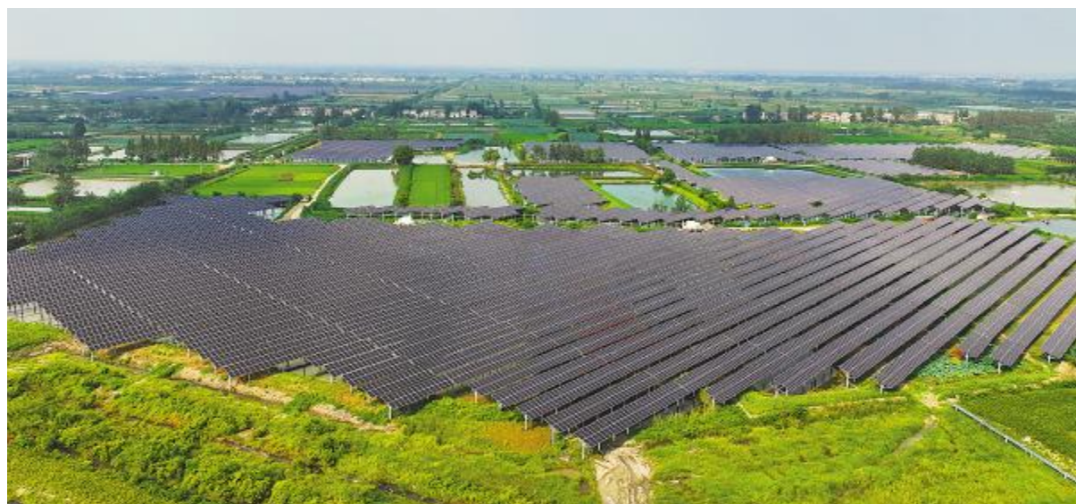
华润(仙桃)陈场200MW渔光互补项目
