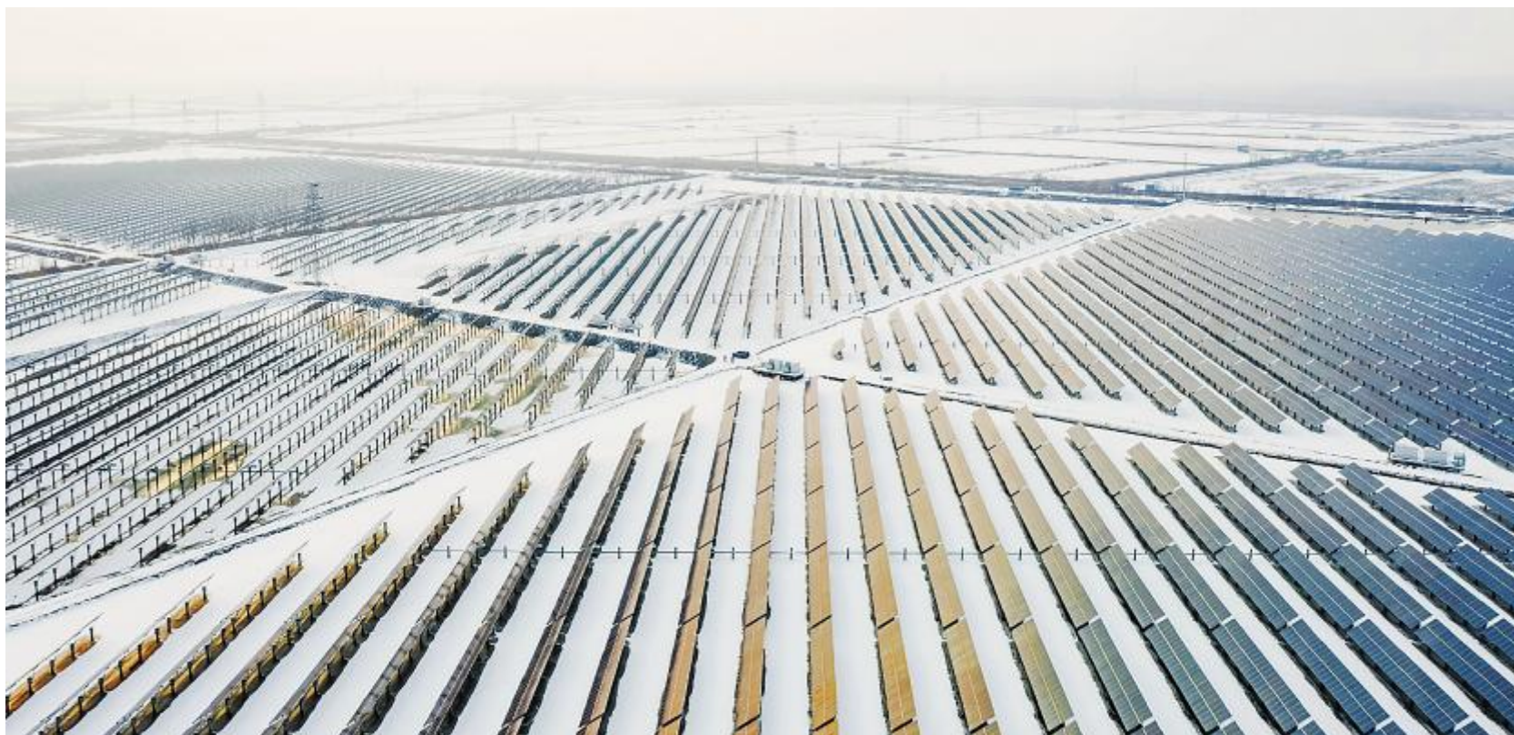
天津明致光伏电站白雪皑皑
